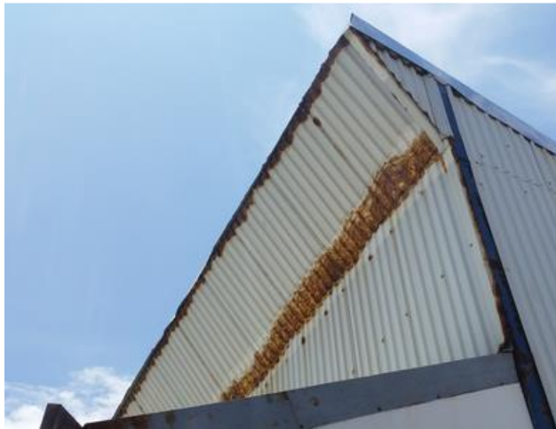
Fig. 2: Tapichel y alero con problemas de corrosión
