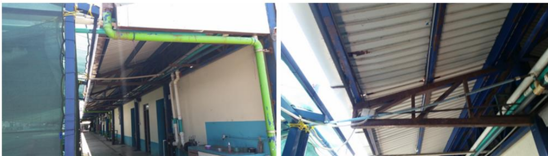
Figura 1: Sección sur del techo del corredor del edificio principal a remodelar y mejorar.
