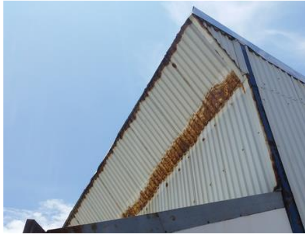
Fig. 2: Tapichel y alero con problemas de corrosión
